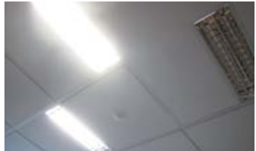
Déconnexion de tubes fluorescents pour réduire le niveau d'intensité de l'éclairage artificiel
