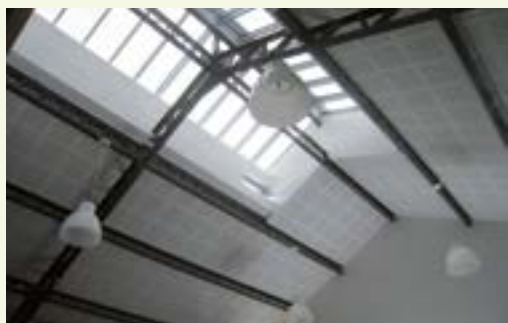
Conservation de la verrière dans un bâtiment de bureaux à Saint-Etienne (Atelier d'Architecture RIVAT)
