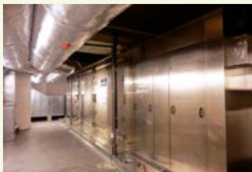
CIRMA - Centrale de Traitement d'Air
