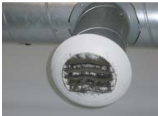
Etat d'encrassement d'une bouche de ventilation
