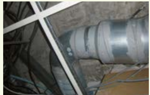
Passage de réseau aérodynamique entre couloir et bureaux
