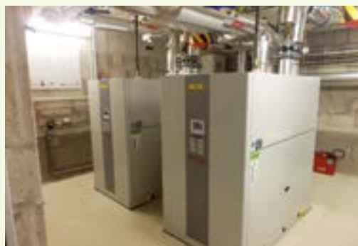
Chaufferie PAC géothermique sur nappe
