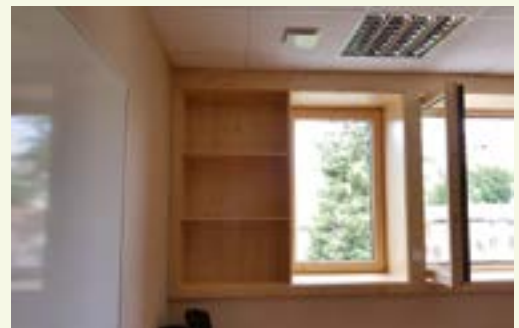
Diffuseur plafonnier pour assurer le soufflage dans les bureaux
